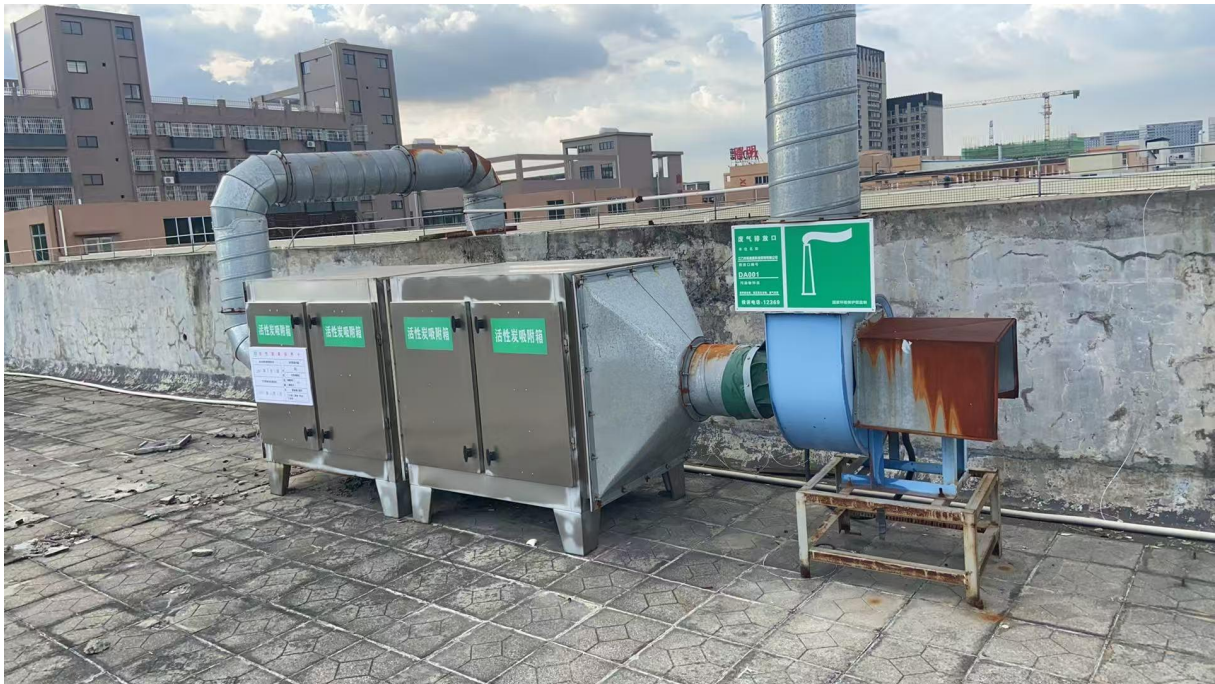
图 4-1 废气治理设施图
