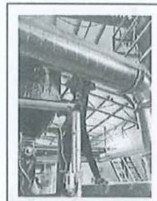
搅拌工序废气 2#处理前
